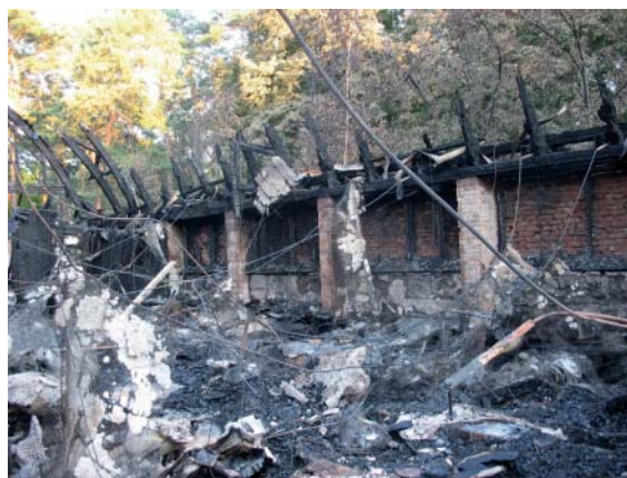
Zgliszcza wewnątrz pawilonu
